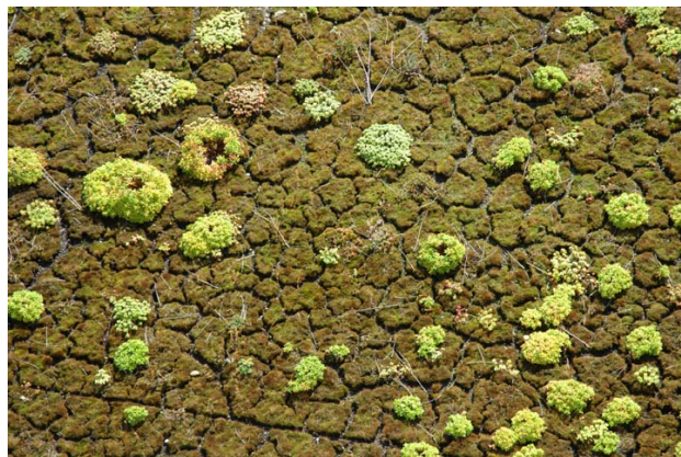
Figur 2: Die Dachflächen der Empa wurden extensiv begrünt, um die Rückhaltung des Regenwassers zu verbessern.
