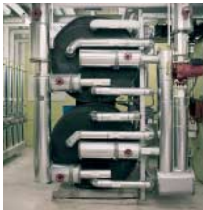
Heizzentrale der Gebäude in der Felicitas-Füss-Straße.
