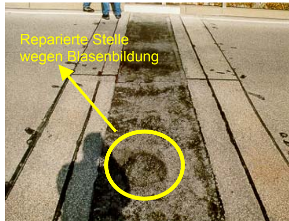
Bild 17 Aussehen eines der SJ Fahrbahnübergänge am Objekt Bönzigenrampe BE (1) nach über 6 Jahren Betriebsdauer
