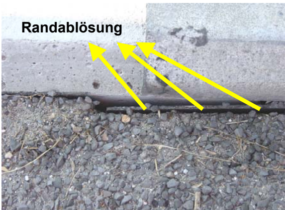
Bild 19 TG (7), Thurbrücke: Randablösung zwischen Muldenfüllung und seitlichem Metallblech.
