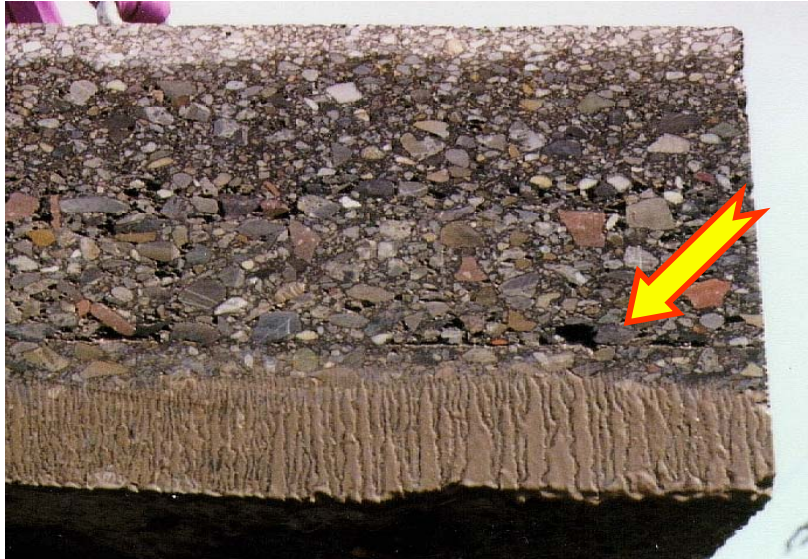
Abbildung 1.1: Schichtenverbundprobleme zwischen Heißmischtragschicht und Heißmischfundationsschicht bei einem frisch eingebauten Autobahnbelag
